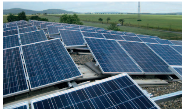
Bild 2: Photovoltaikanlage auf dem Dach der Trinkwasserverwaltung
